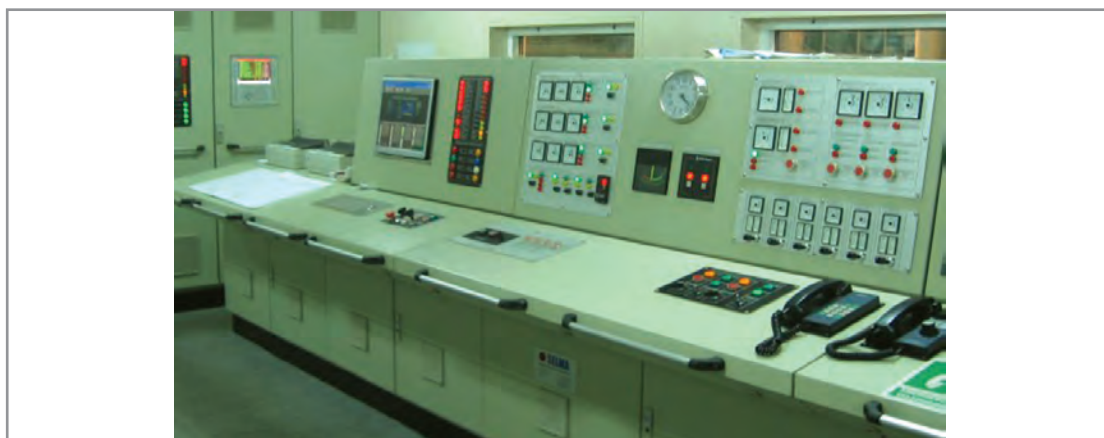
شکل ۴۰ - سامانه هشدار اتاق کنترل موتورخانه
